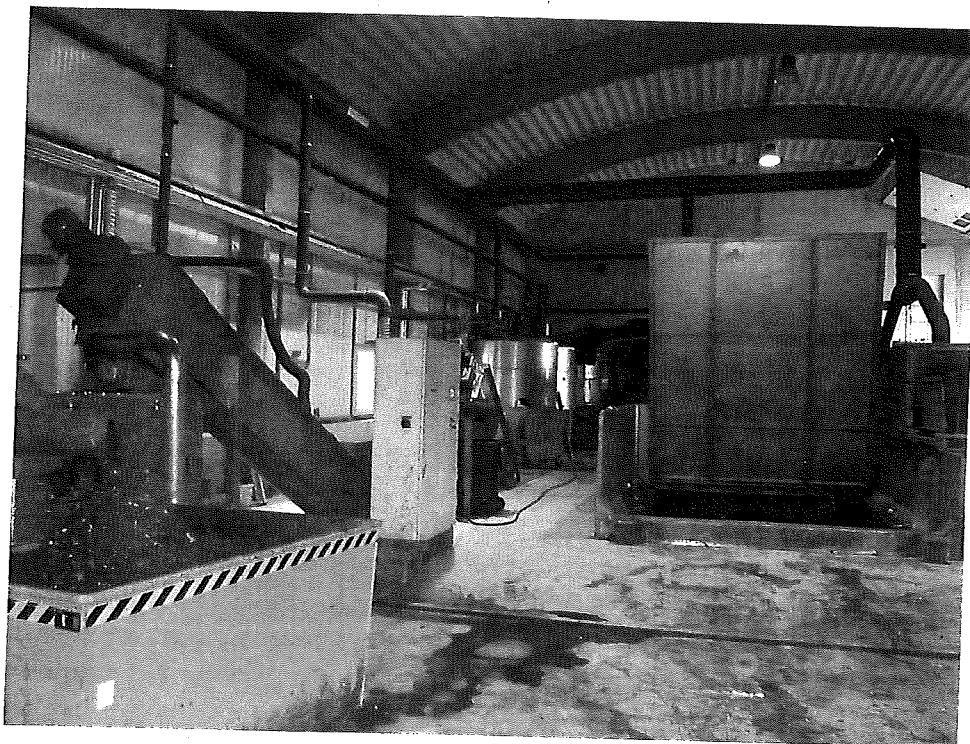
Obr. 8.34 Přijímací hala bioplynové stanice [21]
