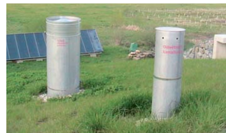
Foto 3: vyústění odpadního vzduchu, odvětrání kanalizace a část solárních panelů Centra ekologických aktivit Sluňákov
